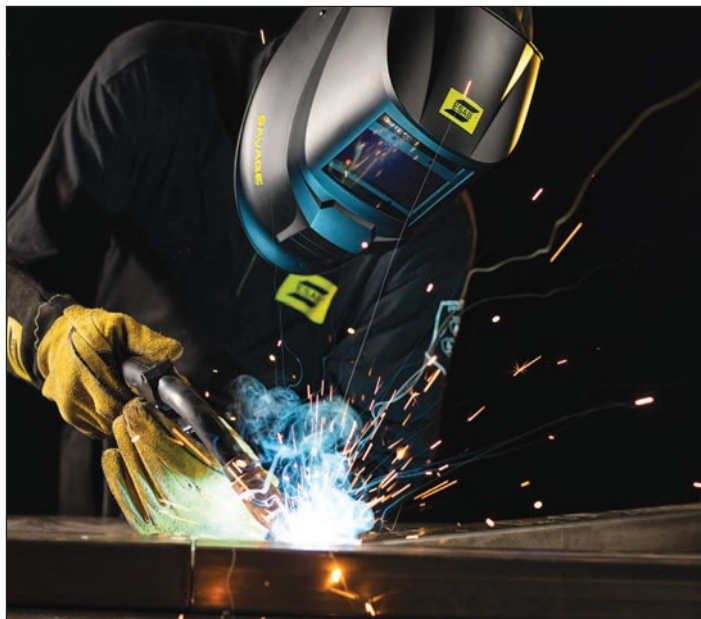
↓ Σχ.3 Η συγκόλληση MIG (GMAW) είναι δημοφιλής μέθοδος για συγκόλληση σωλήνων επειδή είναι εύκολη στη χρήση και παράγει συγκόλληση υψηλής ποιότητας.ESAB
